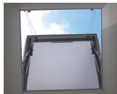
片側開閉 見上げ (開閉途中)
